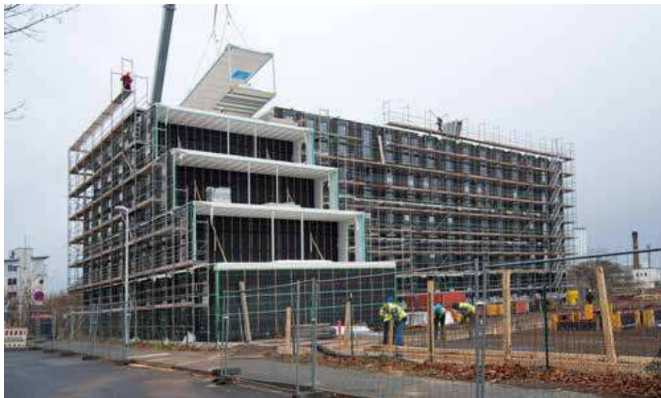
Der Unterschied zum Massivbau ist der Austausch des Tragwerks durch bekleidete Stahlrahmenkonstruktionen
