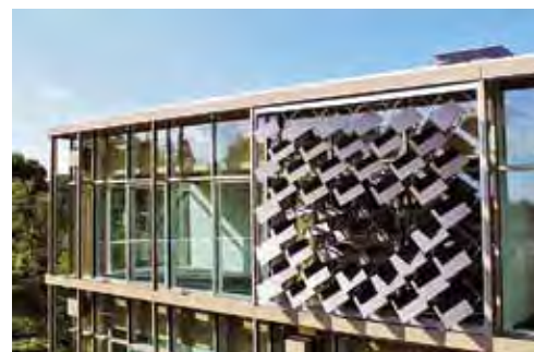
Das Institut Technologie der Architektur der ETH Zürich brachte 50 bewegliche Solarmodule auf der Gebäudehülle auf
