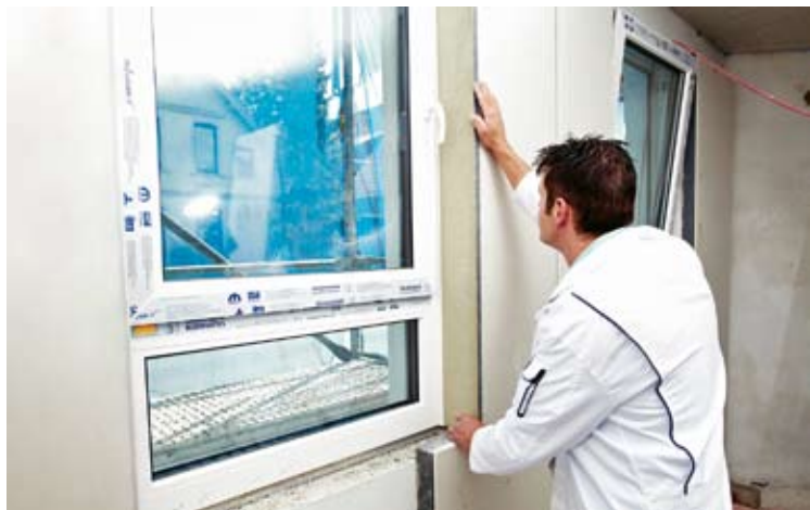
Jede zusätzliche Dämmung in der Fensterlaibung ist besser als keine. Schon eine nur 20 mm dicke EPS-Platte sorgt dafür, dass die Wandoberflächentemperatur im Bereich der Fensterlaibungen erheblich ansteigt, die Anforderungen der DIN 4108 werden jedoch in der Regel nicht erreicht
